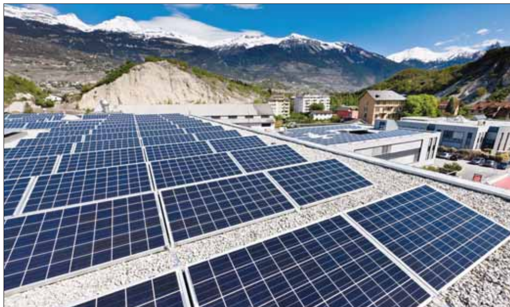
781 panneaux photovoltaïques recouvrent les toits du Techno-pôle de Sierre. DR
