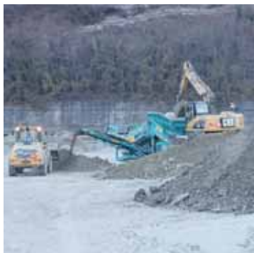
Sur place, on trouve des installations de pesage, un laboratoire, une station de traitement des eaux et des installations de traitement des matériaux par criblage et lavage. REMO
